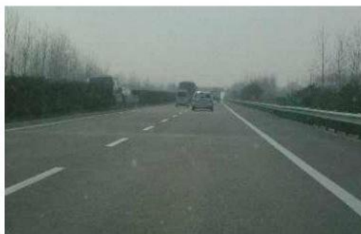
图 6 竣工通车 4 年道路情况
