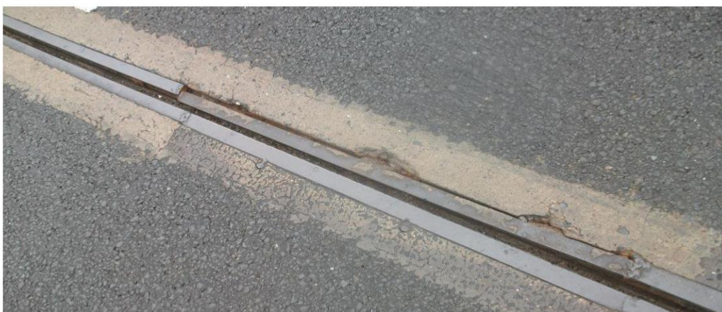
A.2 大位移模数伸缩装置，缝隙间积满尘土垃圾，未及时清理
