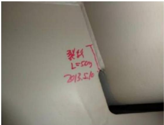
a) 紧贴焊缝焊缝扩展
