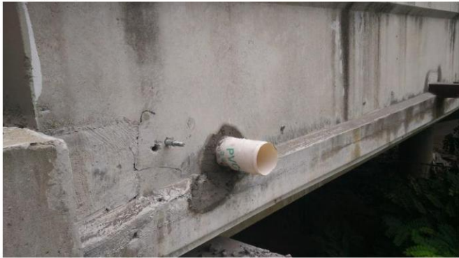
图5 伸缩缝与墙式护栏交接处泄水口
