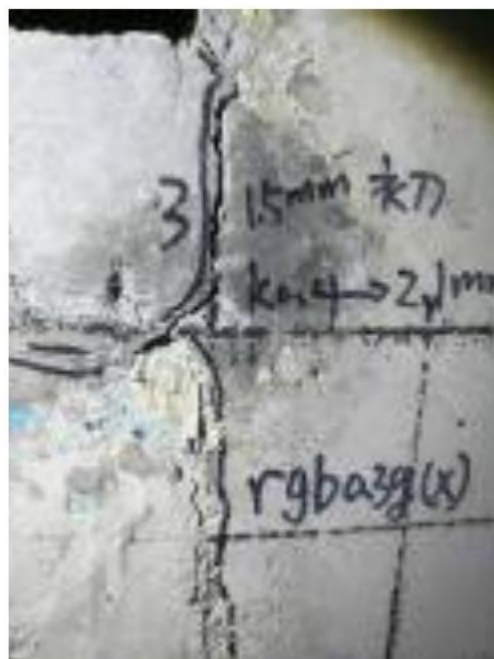
设防烈度 8 度 (0.3g) 时 普通型试验墙保温体系与混凝土墙体间错动裂缝
