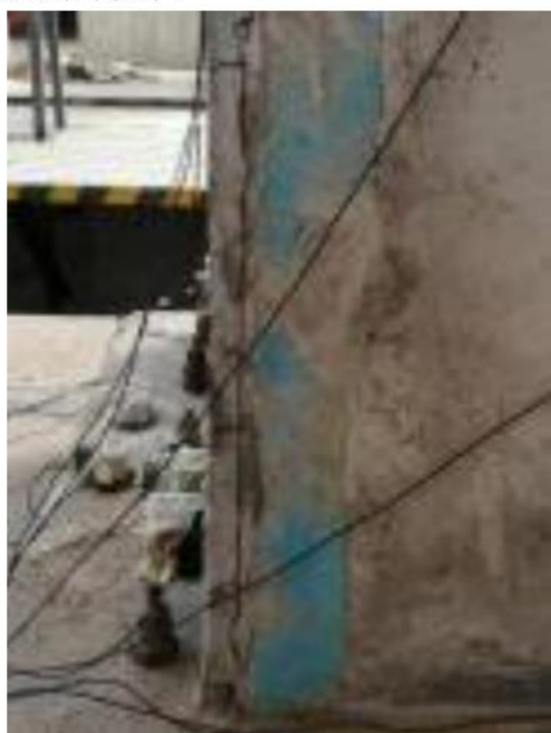
设防烈度 8 度 (0.3g) 时 普通型试验墙找平层与模板间脱离裂缝
